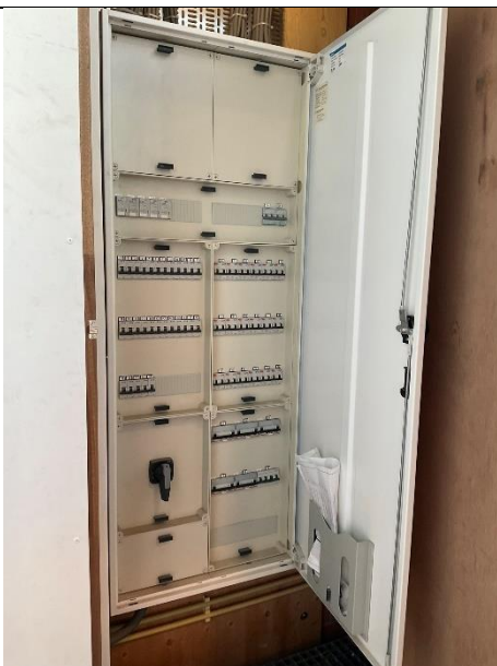
Afbeelding 51: Verdeelinrichtingen trappenhuis, eveneens aanwezig op 1ste, 2de en 3de verdieping.
